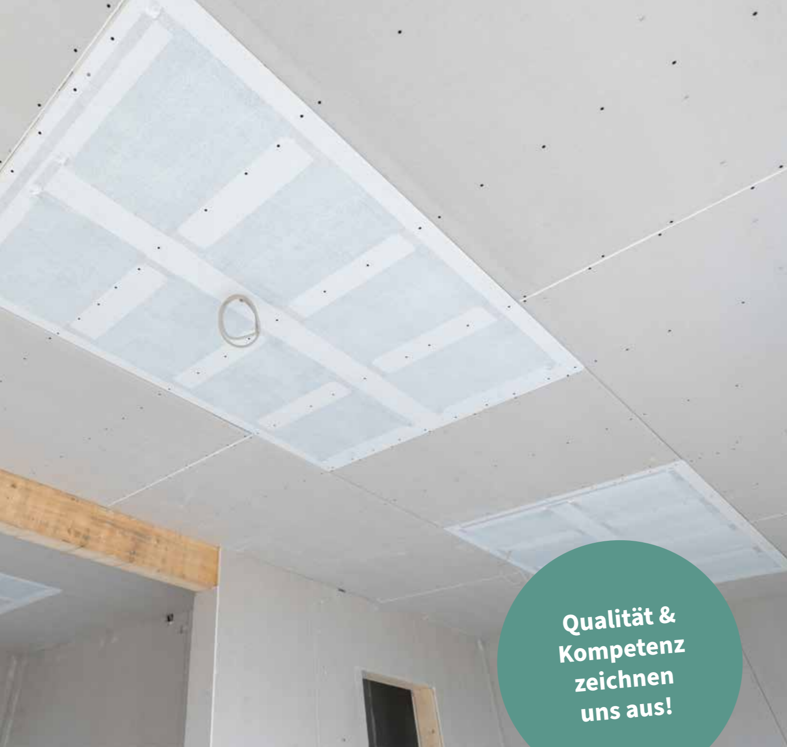
Referenzobjekt der Zimmerei Ziegler mit thermoheld-WAND- als Heizung an der Decke
